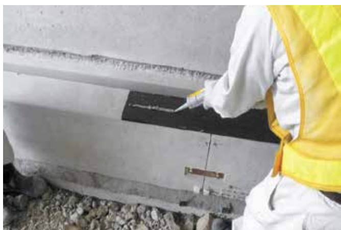
▲ボンドライン塗布状況 (使用量 約20ml/m(口径Φ5mm)) ボンドライン1本で約16m分を使用目安として下さい。
